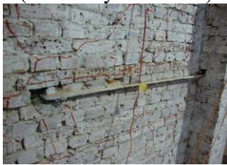
(d) Connecting Joint Failure (Interstory drift 1/100)
